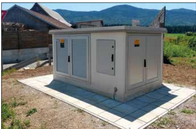
Sliki 9: Novograjena transformatorska postaja
