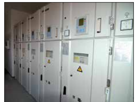
Slika 3: Sodobno srednjenapetostno stikališče
