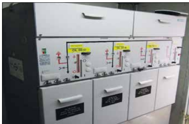
Sliki 10: SN-stikališče v transformatorski postaji
